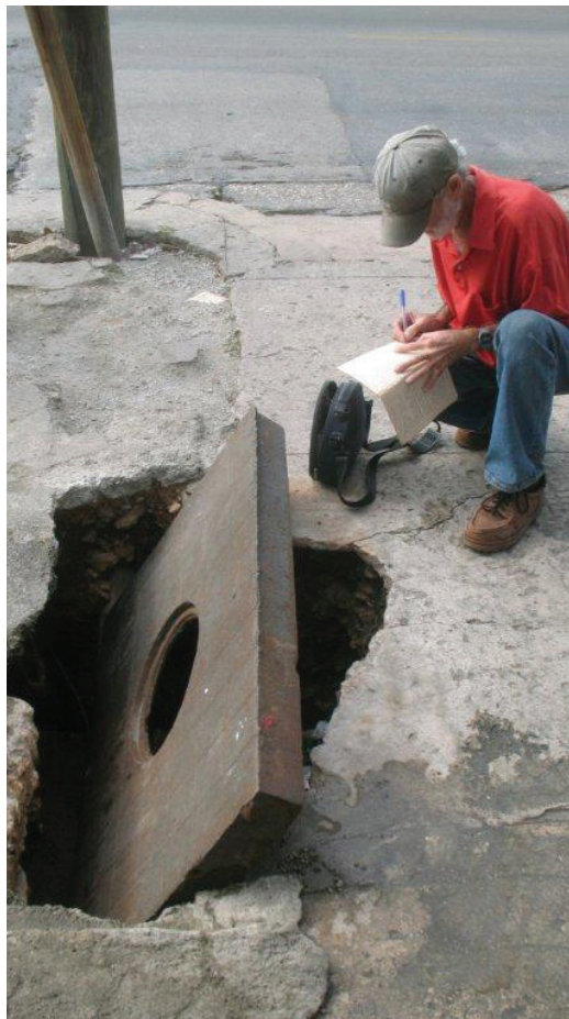
Hundimiento parcial de la tapa del alcantarillado situado a un lado de la fachada del cine Embajador, en el capitalino municipio de Playa. FOTO: CORTESÍA DEL DOCTOR EFRÉN JAIMEZ SALGADO
